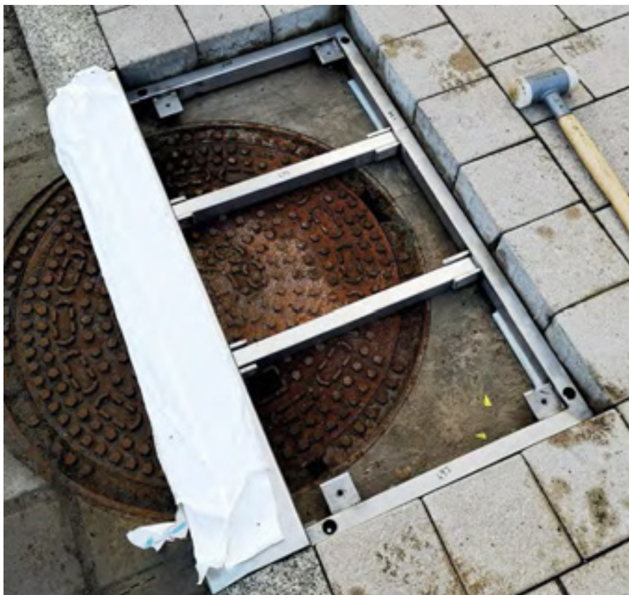
Der Tragrahmen mit Höhenanpassungen wurde durch Verstrebungen verstärkt (Foto: Abwasserwerk Frankenberg)
