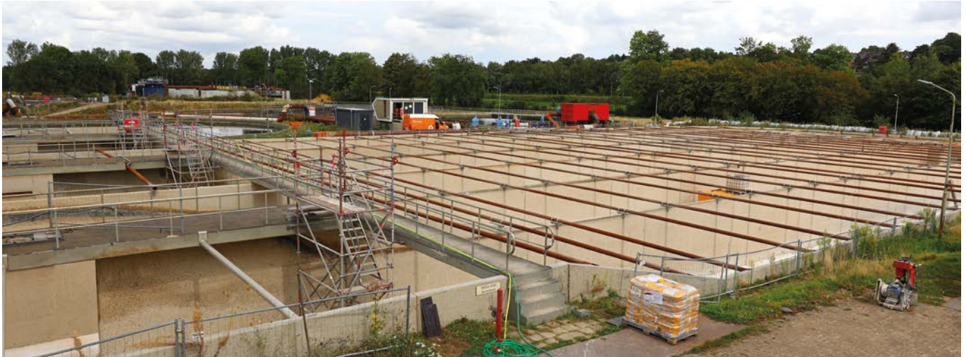
Blick auf das Belebungsbecken
